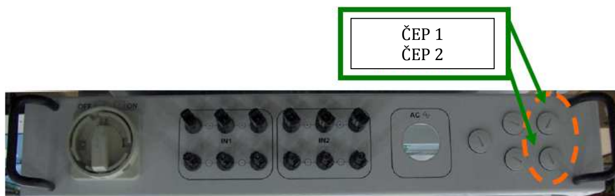
Slika 25 - Izvrtini, skozi kateri speljete kable za priključitev RS-485 ali kabelsko napeljavo za priključitev konektorjev RJ12
